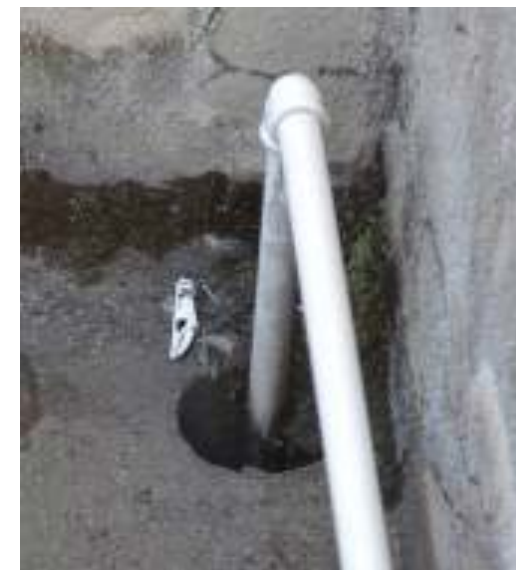
Figura 04 – Garra de siri na calha, próximo do tubo de queda. Fonte: Acervo Arte Real Arquitetura.
